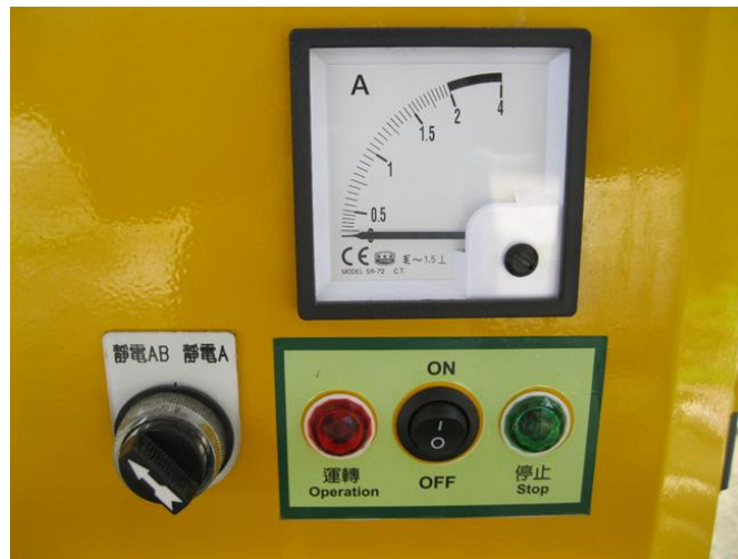
圖 3-9、靜電集塵器之設備使用電流儀錶
